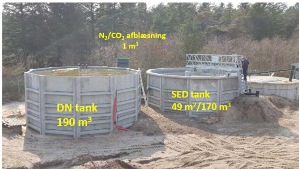
Figur 8-3 Billede af denitrifikations procestank og efterklaringstanken ved Danish Salmons produktionsanlæg i Hirtshals i konstruktionsfasen.
